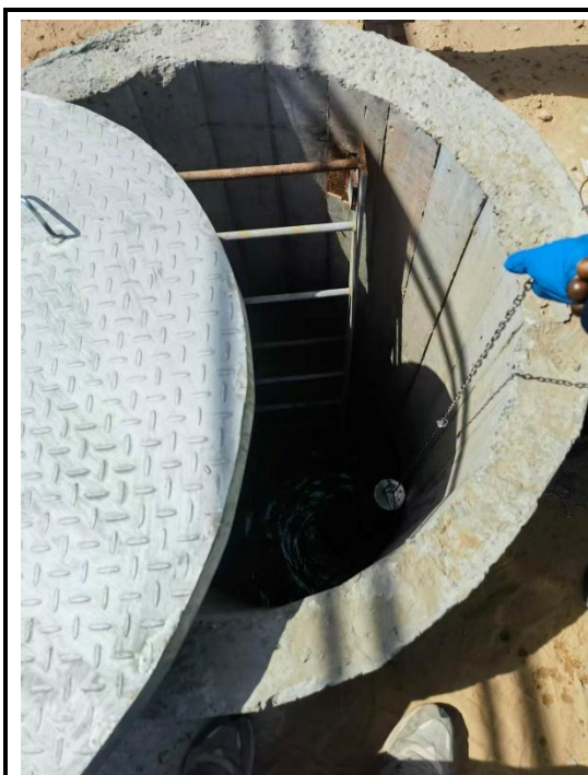
DA001-排放口、梯架等
