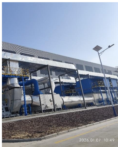
碳化车间废气处理设施 (RTO炉)
