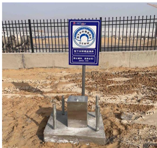
2#地下水监控井 (出水监测池旁)
