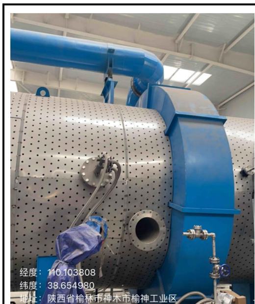
碳化车间废气处理设施 (DFTO炉)
