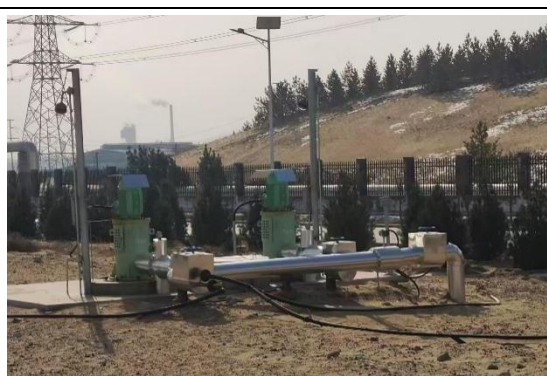
事故水排水泵
