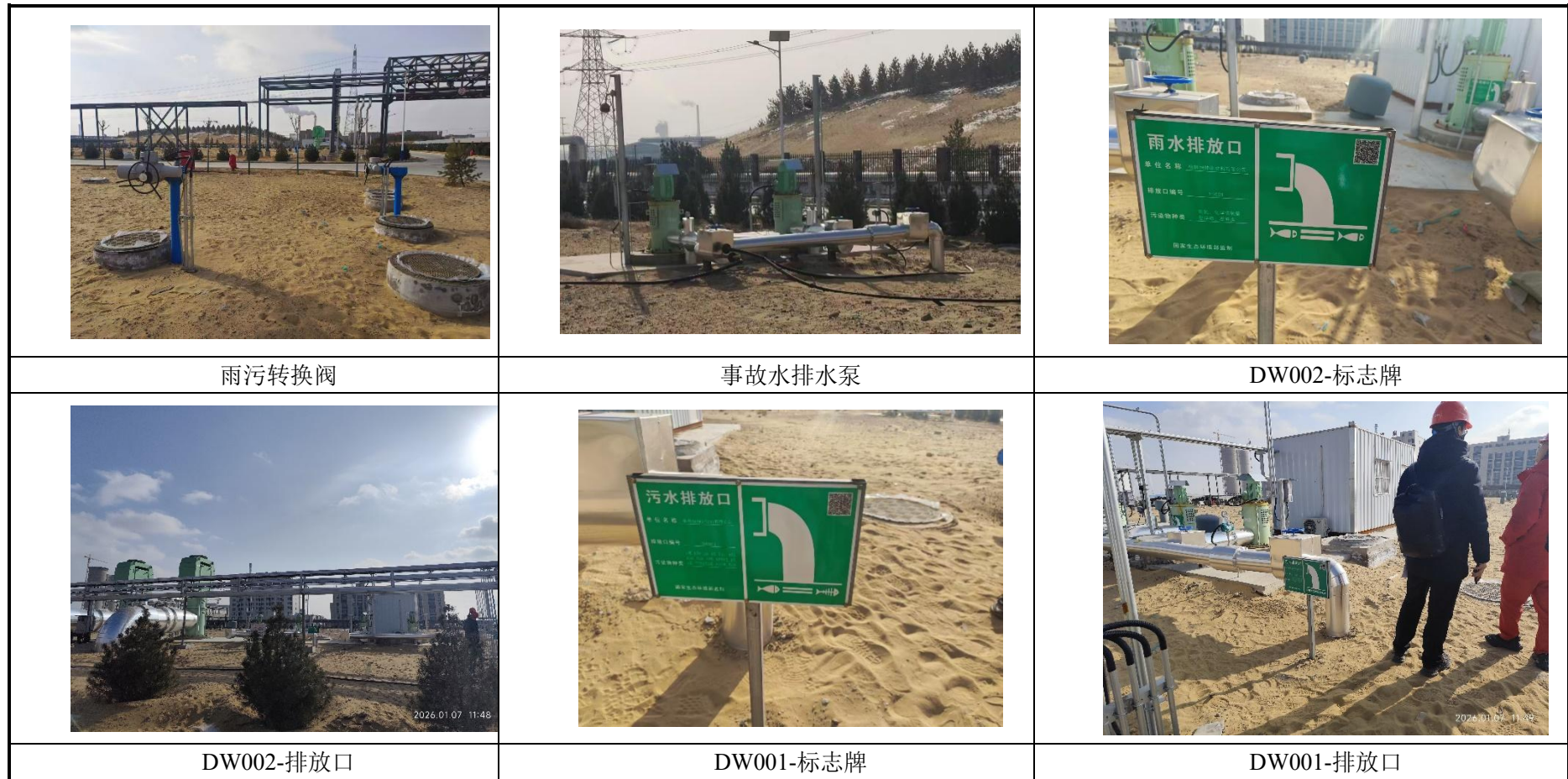
图 4.1-2 废水排放设施图片
