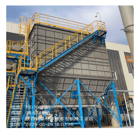
碳化车间废气处理设施（袋式除尘器）
