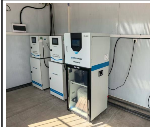
废水在线监测设备线路连接
